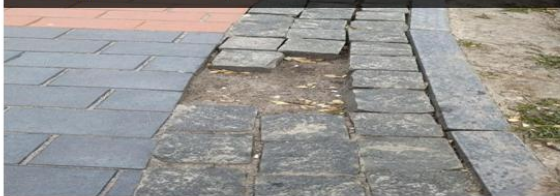
Фото 4. Порушення цілісності покриття
